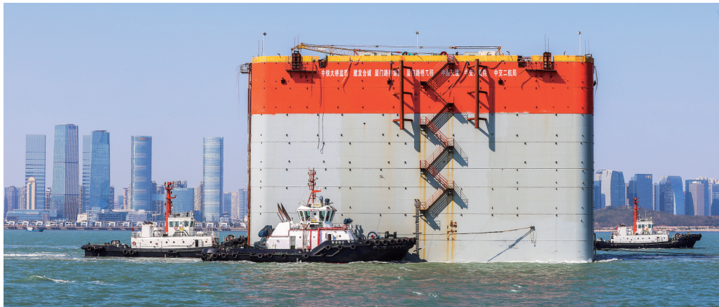
厦金大桥(厦门段)刘五店航道桥最后一个钢沉井日前拖运就位。记者 唐光峰 摄
